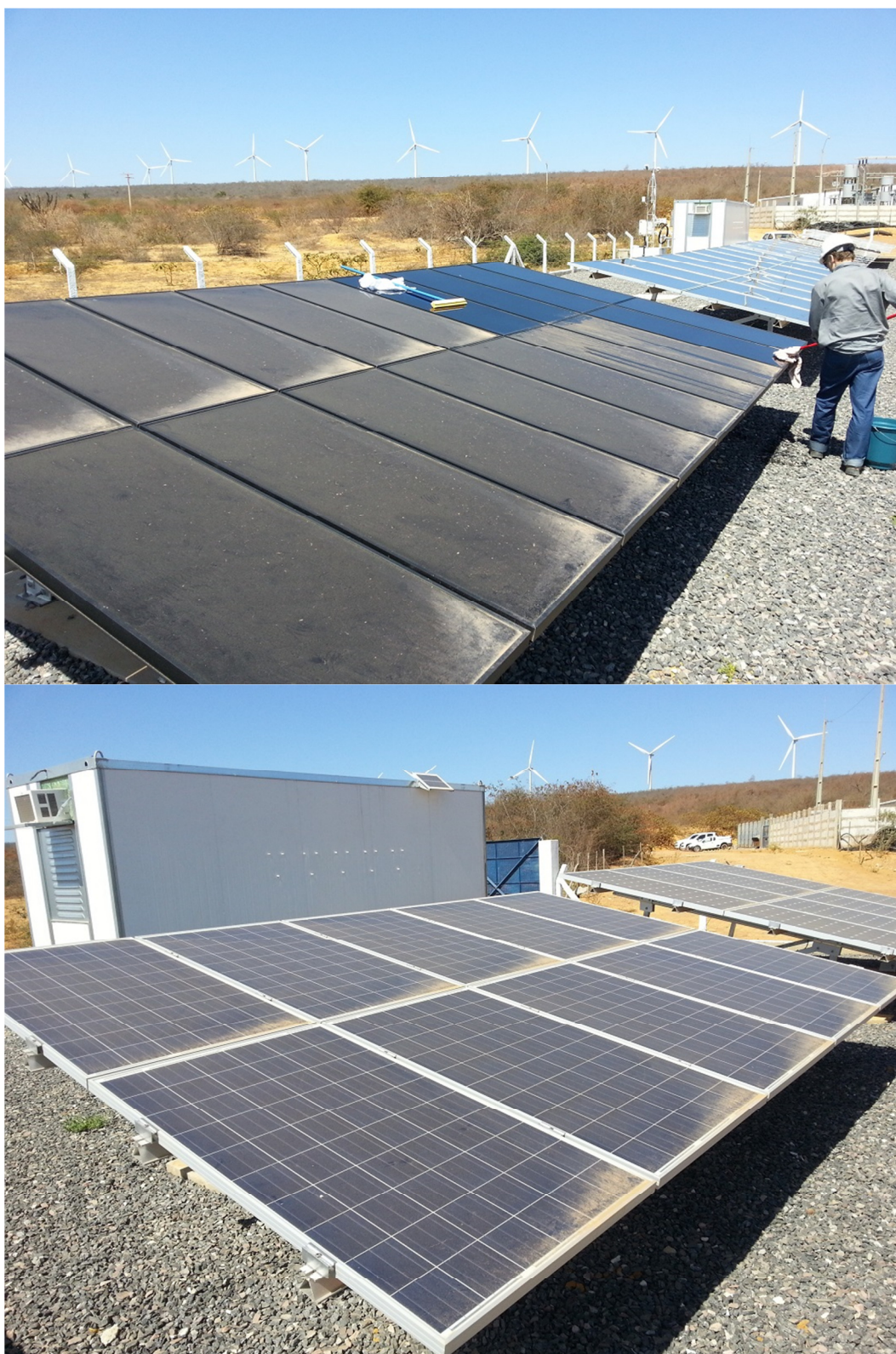
Figura 32: Exemplos de condições de empoeiramento pesadas e não uniformes em um local de teste de sistemas FV na região Sudeste do Brasil. Não uniformidades no padrão de sujeira são causadas principalmente pelas condições de vento forte.
