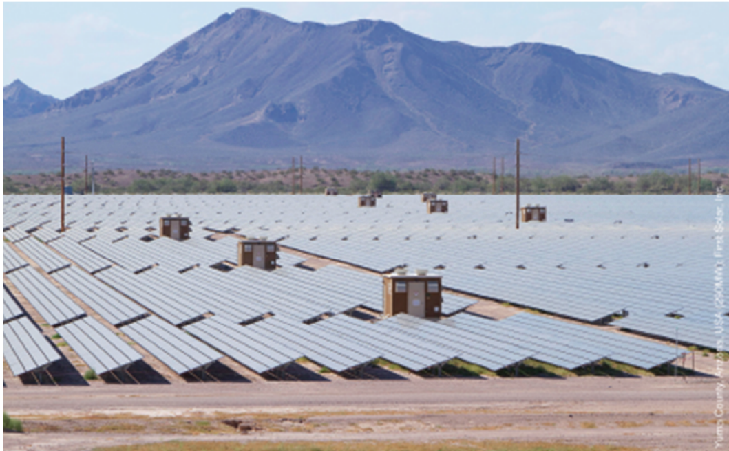
Figura 34: Usina FV de CdTe da First Solar no condado de Yuma, no Arizona, EUA, com 290 MWp, com controle da usina de modo a oferecer suporte à rede elétrica pública [67].
